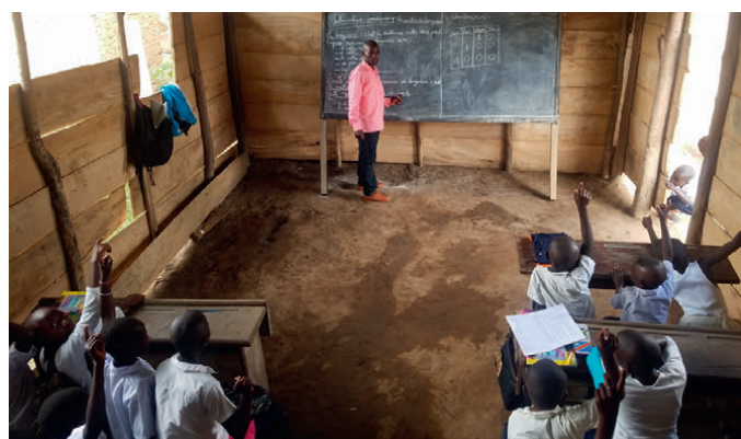
Le bois n'a pas suffi pour toute la construction du mur de la nouvelle école. Quand il pleut, l'humidité envahit la salle de classe.
